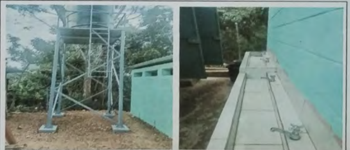
Foto 16: vista de Torre de METAL para sostener deposito plastico para depositar agua potable. Vista de lavamanos de concreto con instalacion de agua potable y grifos.
